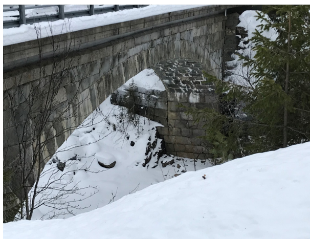
Kvisla bru vart i 1990 forsterka med betong på toppen, etter dagens krav. Foto: Lars Hamarsbøen 2024.
