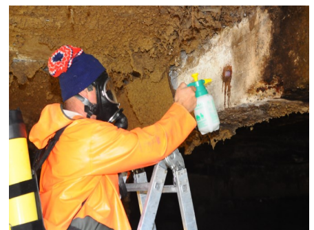
Påspritjing av fenolftalein avslører raskt kor langt inn karbonatiseringa har trengt.
