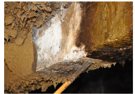
Typisk skade på dragarar i gjødselkjellarar. Rustangrep på armeringa fører til at deler av betongoverdekkinga losnar og fell av.
