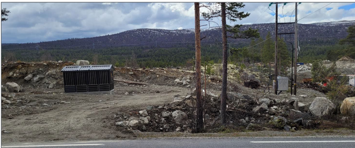
4-8 Bilde som viser nyetablert trafo og dagens luftstrek som skal legges i jordkabel
