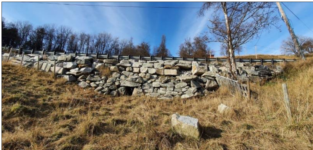
Figur 4-7 Natursteinsmur. Deler av muren har sklidd ut [befaring 18.10.2021].
